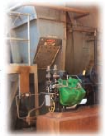
I.D. Fan Drives
